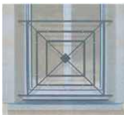
Le garde corps acier
